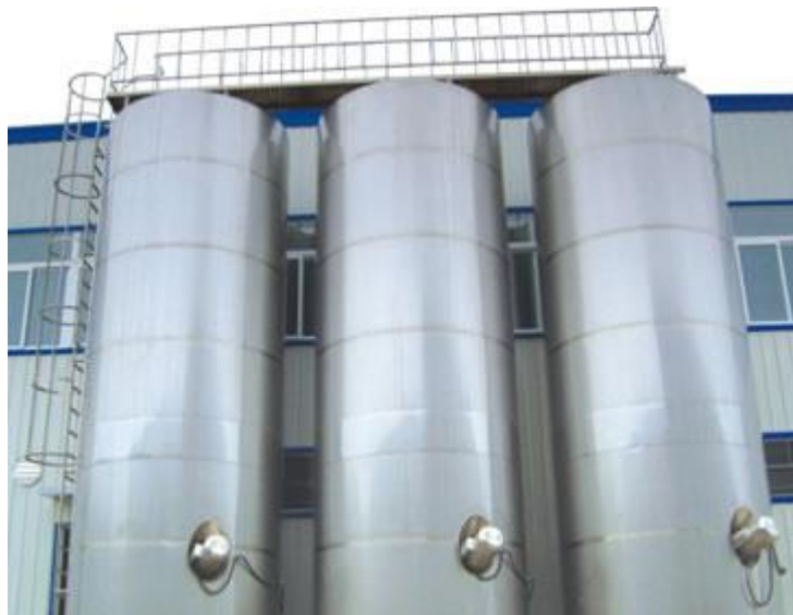
Fig. 12.12 Tancuri de depozitare lapte exterioare
